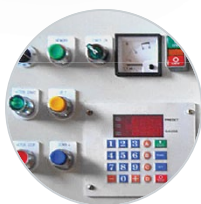
centralny panel kontrolny centralized control panel
