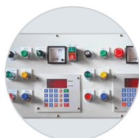
centralized control panel centralny panel kontrolny
